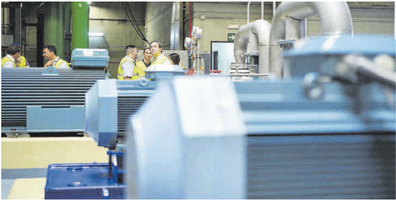
Instalaciones de Aqualia en Adeje.
