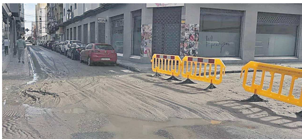
La calle Clavel, tras la rotura de una tubería este domingo.
